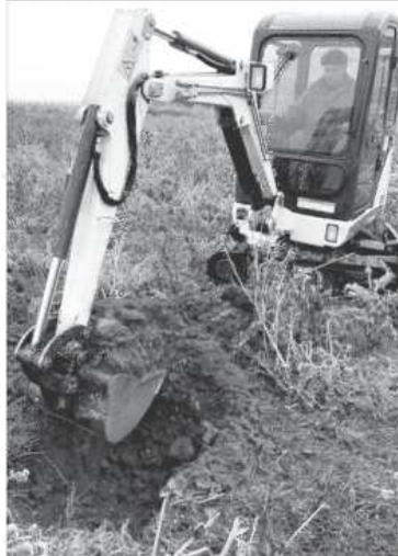
Ein Minibagger spart Muskelkraft: Auf einem knapp einen Hektar großen Hanggelände an der B 41 wurden damit am Montag 50 Pflanzlöcher gebuddelt. Das DLR ist Vorreiter bei der Obstbaumaktion. Ob weitere Grundeigentümer mitmachen, ist offen. Das Sonderangebot gilt auch noch 2009.
